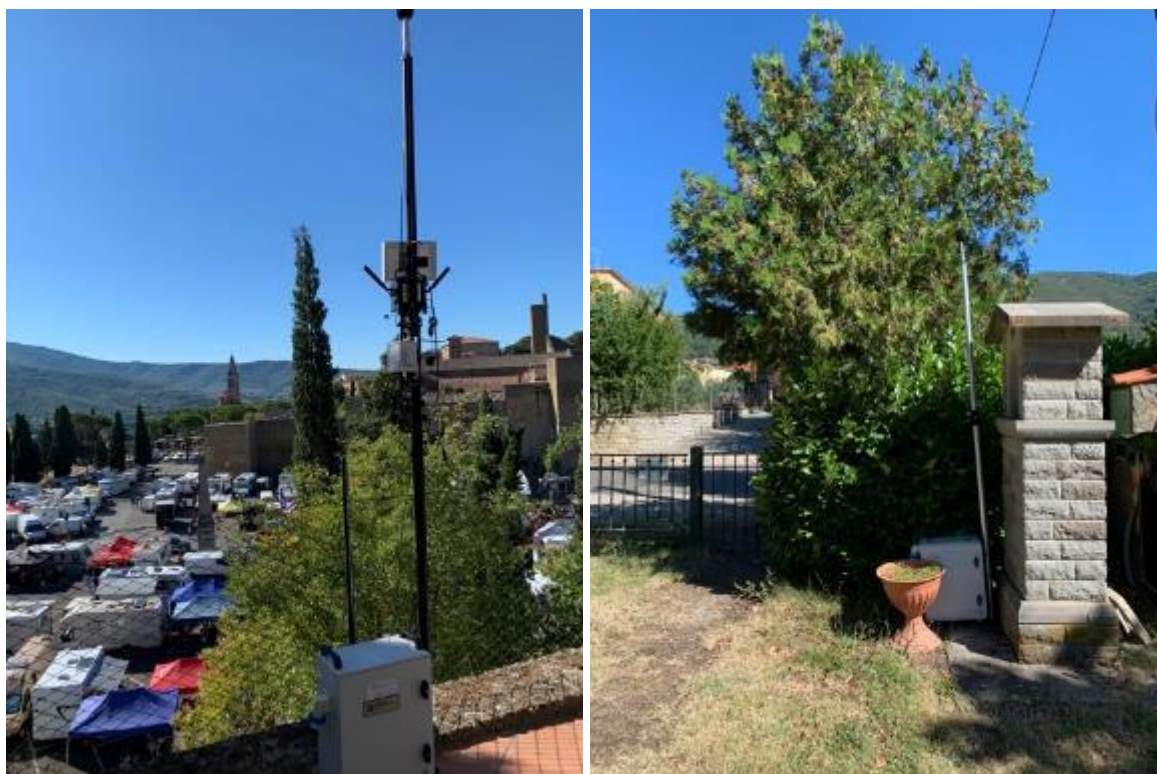
Figura 3 – Posizioni installazione centraline acustiche (P01 e P02)
